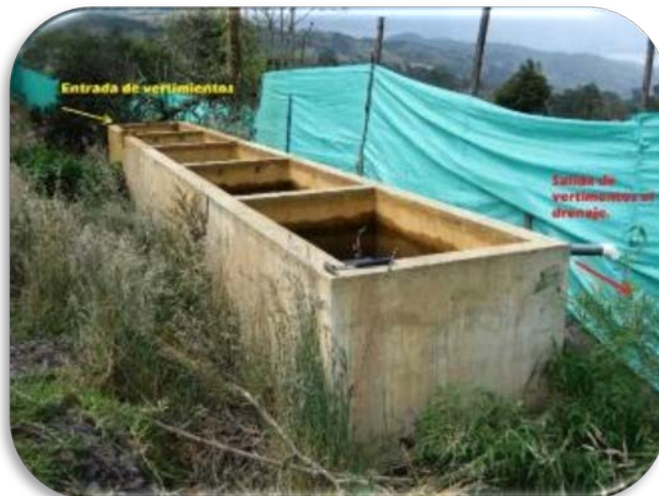
Foto 4. 28. Piscinas de decantación para tratamiento de vertimientos de la mina de carbón, los vertimientos salientes se dirigen directamente al drenaje ubicado a 2 metros de la salida (en rojo).
