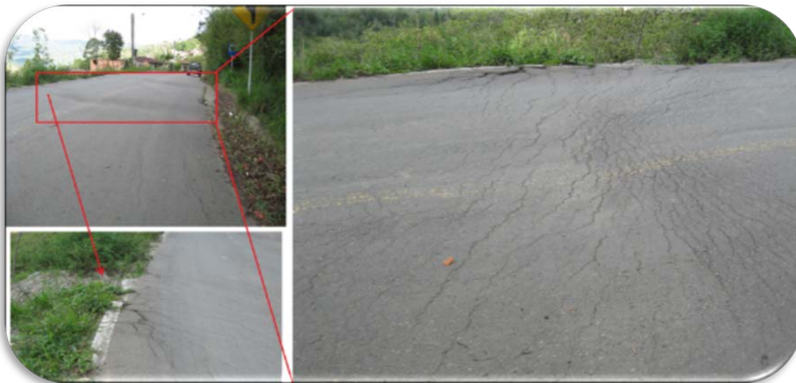
Foto 4. 52. Proceso de reptación y hundimiento de la Vía La Capilla - Tenza.
