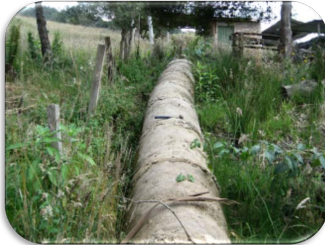
Foto 4. 27. Tubería de concreto de 0.5 m de diámetro por la cual se encauce el drenaje a 20 metros de la entrada del túnel de la mina.
