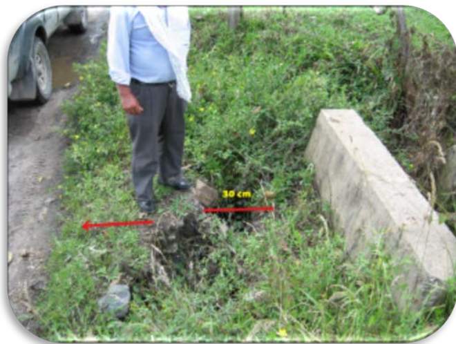
Foto 4. 51. Reptación del terreno con efecto sobre la infraestructura vial, grieta de 30 cm de desaparición, Vereda Barro Blanco, La Capilla.
