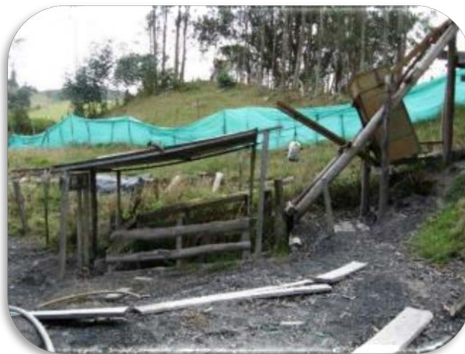
Foto 4. 26. Entrada del túnel, vista del sistema de acoplado para las labores de desembarque del carbón.
