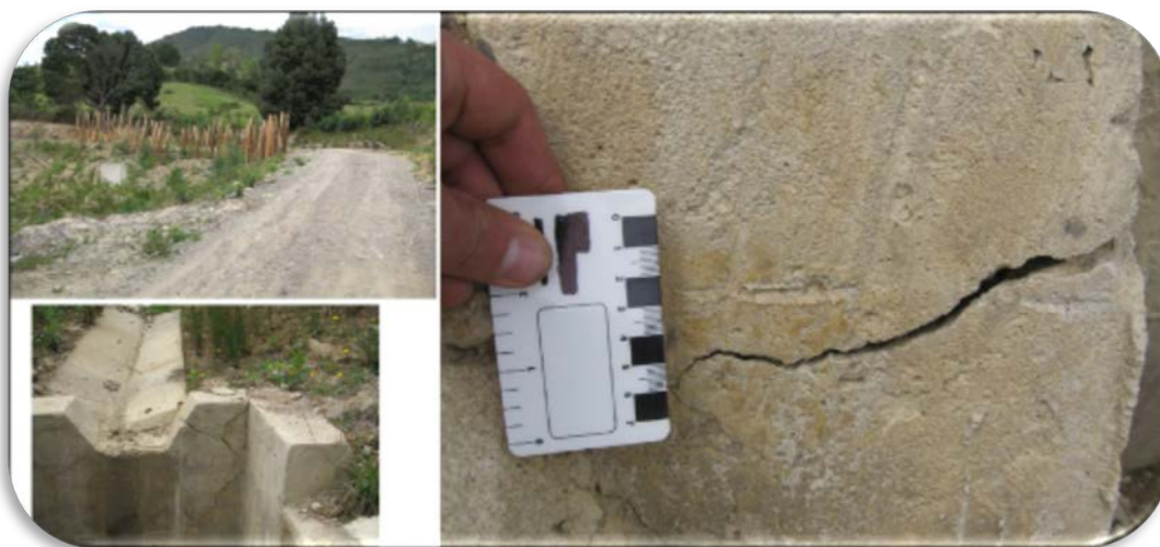
Foto 4. 53. Infraestructura afectada por procesos de remoción en masa, Vereda La Palma, Municipio de Úmbita.
