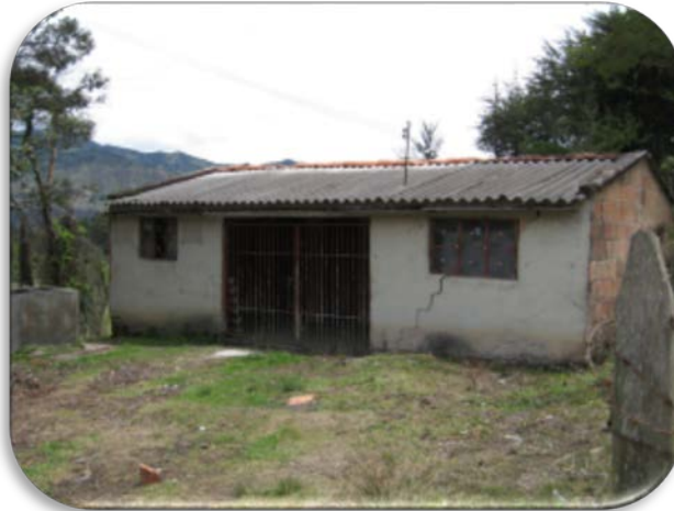
Foto 4. 54. Vivienda afectada por procesos de remoción en masa, Vereda La Palma, Municipio de Úmbita.
